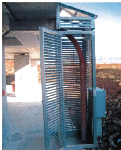
Giunto flessibile per il collegamento della fornitura elettrica dell'edificio al cavidotto dell'Enel
